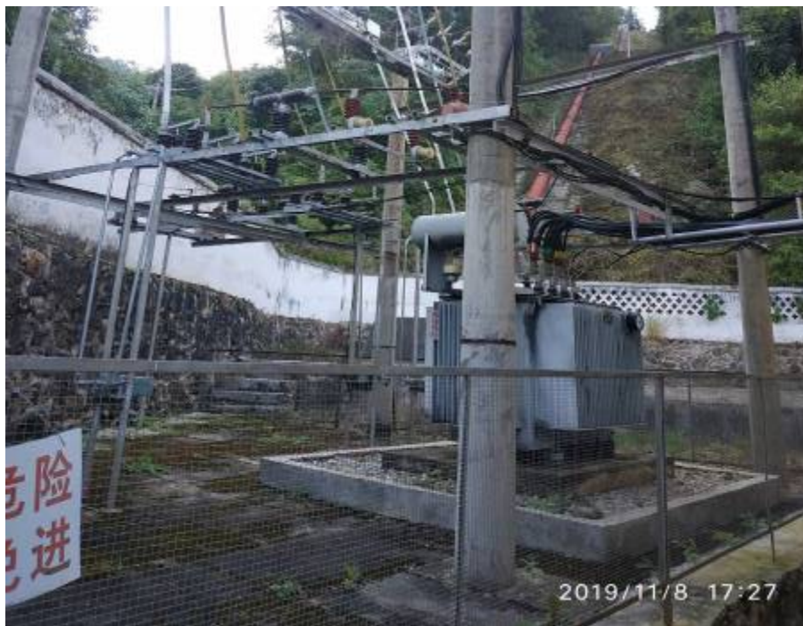
图 5.5-3 变压器下方未设事故油池
